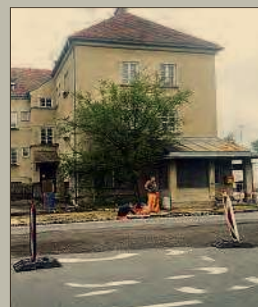
Kleinhaugsdorf: Das Zollgebäude verfällt seit Jahren. Foto: M. Eidlhuber
